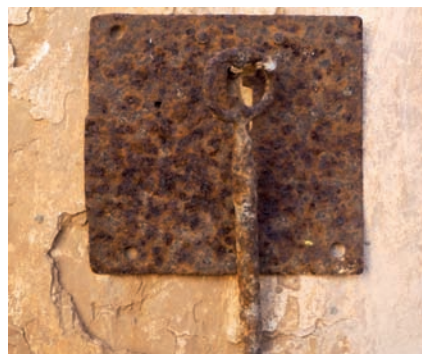
Soporte y llave artesanal en estado de oxidación
